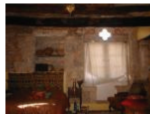
Le château : placard mural et fenêtre géminée à oculus quadrilobé, vus de l'intérieur de la pièce du premier étage
