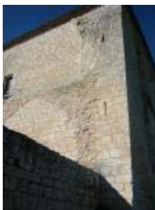
Le château : traces d'arrachement des pièces voûtées disparues (dont l'ancienne chapelle à l'étage) sur la façade sud
