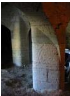
Le château : pilier de la travée voûtée de la cave soutenant le vestibule et la cage d'escalier
