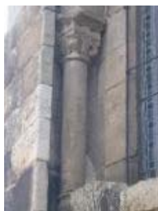
L'église Saint-Pierre-ès-Liens : chapiteau orné de rinceaux sur colonne à pans coupés dans l'embrasure masquée de la fenêtre est du chevet
