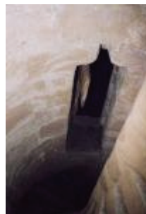
La tour de l'Horloge : cage de l'escalier à vis (premier étage) ; détail sur l'imbrication de l'arrière voussure de la porte et des marches de la vis
