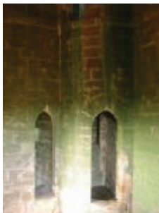
La tour de Sagnes : porte des latrines (gauche) et porte du deuxième escalier en vis (droite)
