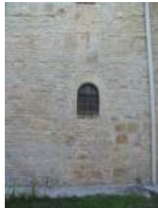
prieuré de grandmontains Notre-Dame, actuellement église paroissiale. Aile orientale, élévation est, détail : traces d'une porte au rez-de-chaussée et fenêtre étroite à l'étage.
