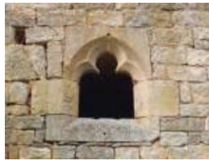
Le couvent : fenêtre à lancette au rez-de-chaussée sur la façade est de la salle capitulaire
