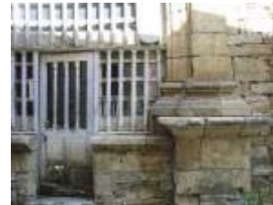
La chapelle Notre-Dame de l'Olm : stylobate du pilastre de droite (façade sud)
